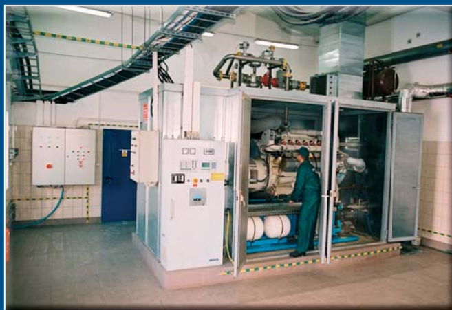
Generator prądowórczy na biogaz
