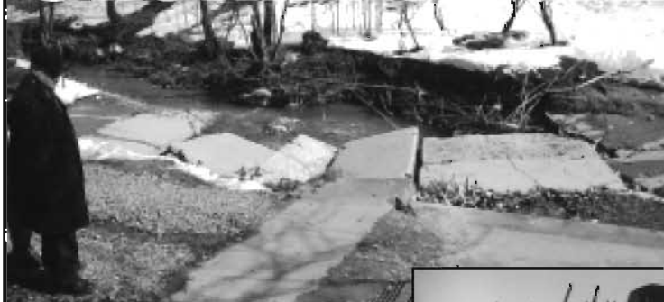
Zniszczony przejazd w Zagorzycach – Chmielówce.
