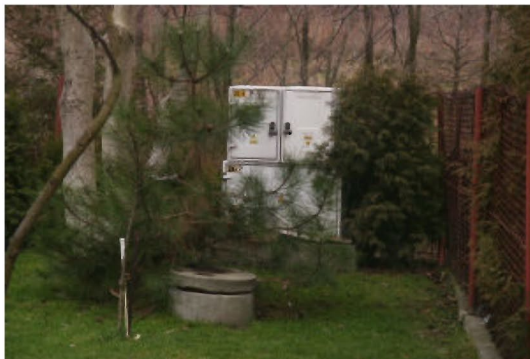
Jedna z przydomowych przepompowni ścieków PRESKAN, która będzie zamieniona na kanalizację grawitacyjną
