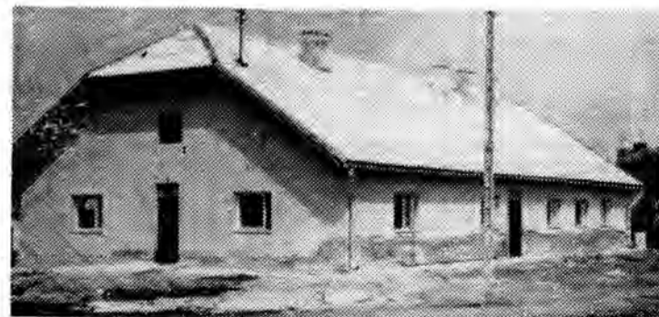
Woda z małego pagórka spływa na ścianę odremontowanego budynku powyżej izolacji. Efekt widoczny na zdjęciu: wilgoć dotarła do połowy wysokości ścian. Fot. TZ
