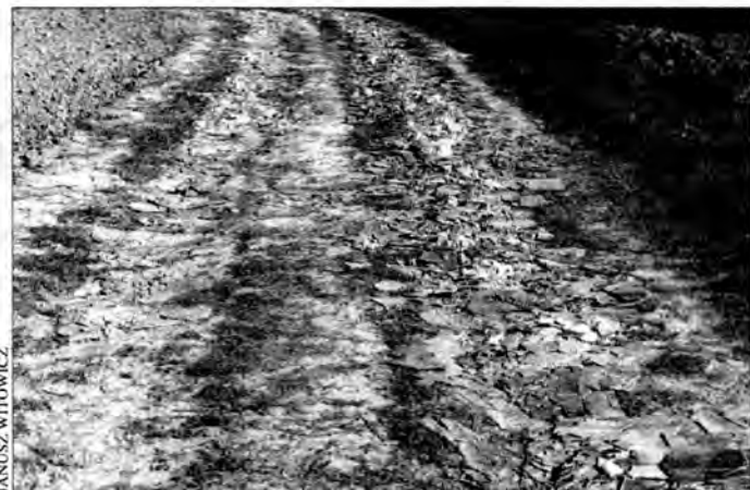
Jedna z wielu polnych dróg w Podkarpaciu „utwardzonych” kawkami azbestowo-cementowych płytek eternitowych. To zdjęcie fotoreporter „Nowin” wykonał w gm. Tyczyn.
