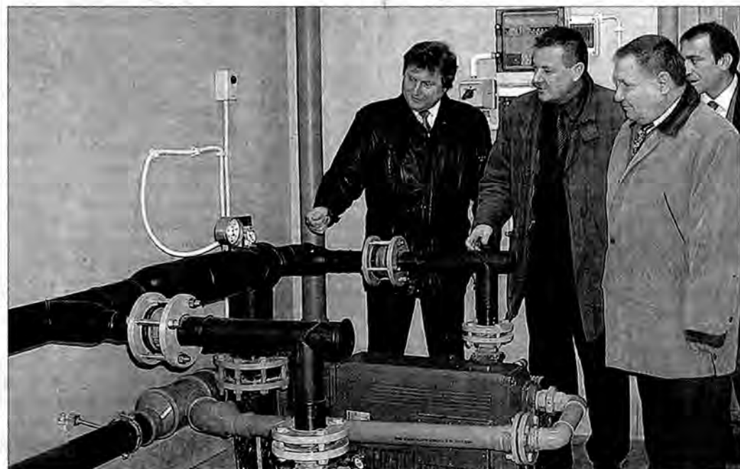
Szwedzkie pompy ściekowe, niemieckie pompy próżniowe i szafa sterownicza „Siemensa” gwarantują niezawodność bezobsługowych urządzeń i stały monitoring nad ich pracą. To druga tego typu stacja w Polsce, wykonana w 9 miesięcy przez spółkę ZISICO w Muninie.
