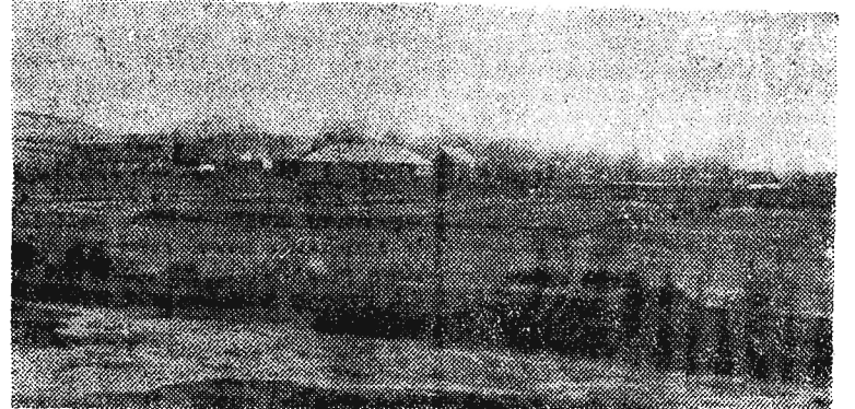
Na zdjęciu: ogólny widok na przyszły stadion. Na pierwszym planie wykop pod basen, w głębi teren pod boisko piłkarskie i nadbrzeżne wały.
