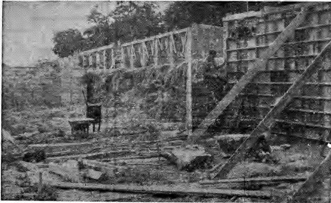
O ile roboty przy budowie garaży przy osiedlu XXX-lecia PRL będą przebiegały w dotychczasowym tempie, to za parę miesięcy właściciele samochodów osobowych wprowadzą do nich swoje pojazdy. Fot. R. PAWŁOWSKI
