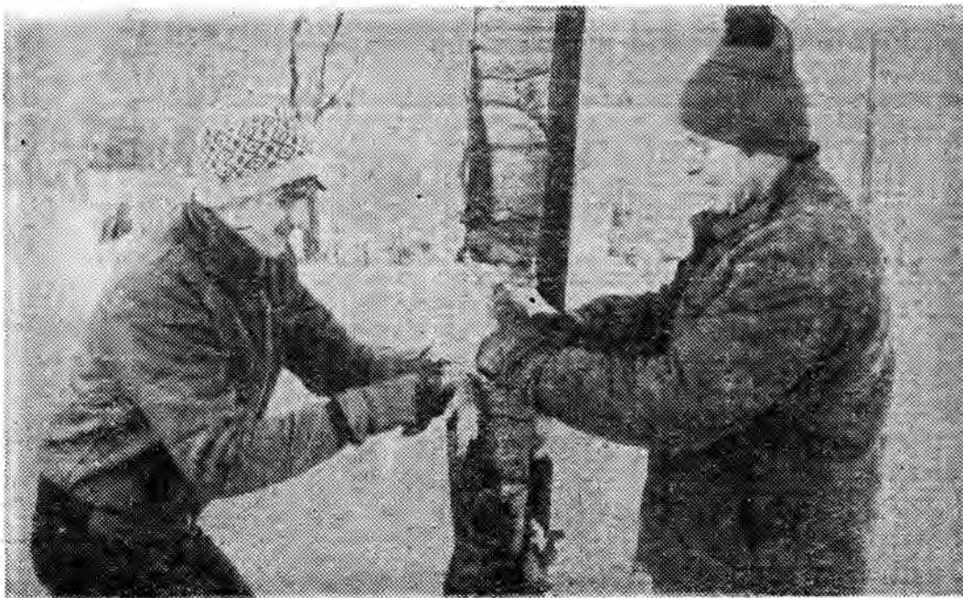
Mról i ostry wiatr zrobiły swoje — mimo izolacji zamrzły przewody doprowadzające ciepło do kopalnianej kuchni i stołówki. Górniczy Krzysztof Łuszczynski i Stanisław Brzeźtoski przystępują do odmrażania rurociągu. Fot. T. ZIEMBOLEWSKI
