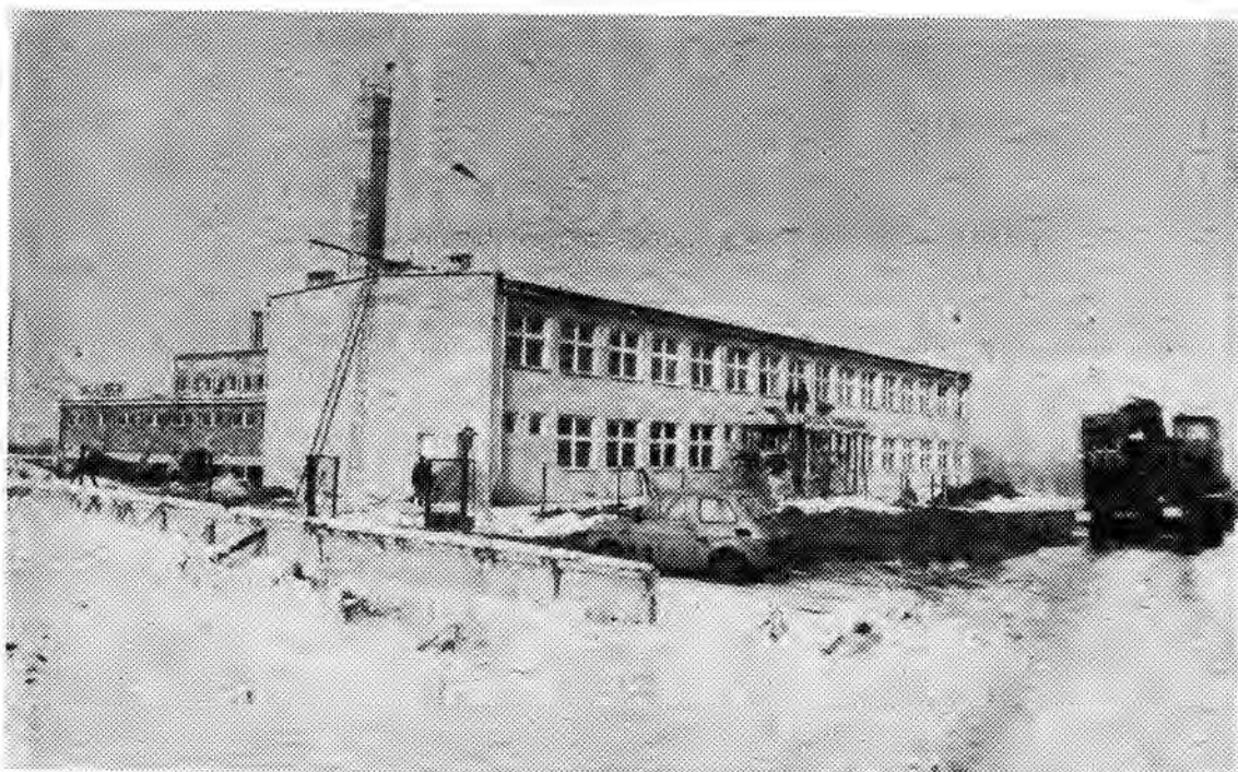
W Zapalowie trwa budowa szkoły wraz z salą gimnastyczną. Prace weszły już w stadium końcowe. Wszystko wskazuje na to, że nowy rok szkolny rozpoczną zapalowskie dzieci w nowym budynku.
