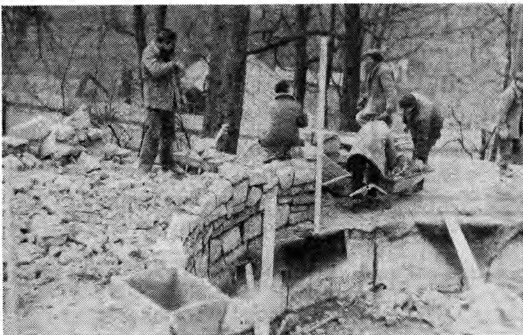
W miejsce czwartej, okrągłej baszty, powstają zarysy murów w formie imitacji trwałej ruiny. Fot. T. ZIEMBOLEWSKA
