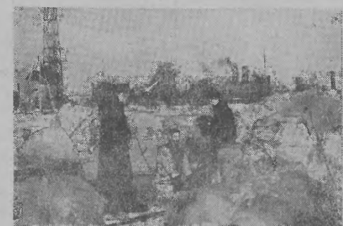
W szybkim tempie postępuje budowa fundamentów pod gmach Kujawskiego Elektrowni Wodnej. Nuchowice kontrolują teren. Na zdjęciu: Nurek M. Pietrow przygotowuje się do zejścia do wody. Foto — CAF
