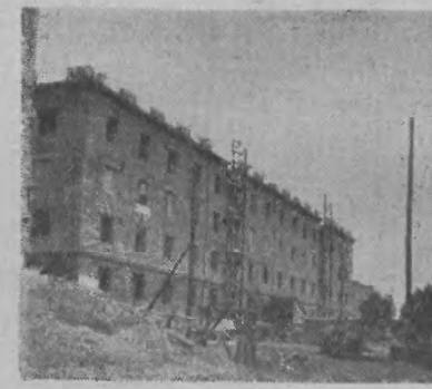
Na zdjęciu: Budowa nowoczesnego osiedla robotniczego w woj. kieleckim. Zdjęcie z 1952 r. CAF — fot. Targowski
