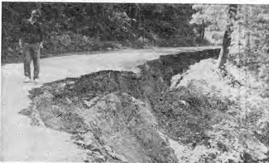
Droga Dubiecko — Śliwnica została zerwana na odcinku około 40 metrów.
