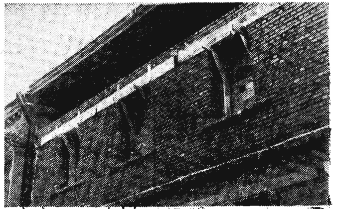
Nareszcie w Rzeszowie przystąpiono do odremontowania, a właściwie do odbudowania „podpieranych” od dwóch lat budynków znajdujących się w Rynku i przy ul. Gałęzowskiej.
