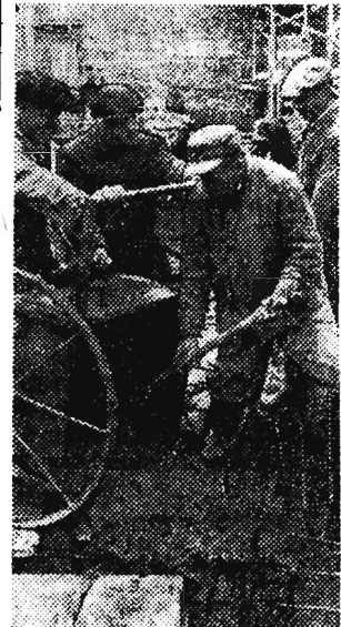
Brygada betoniarska Mieczysława Wisza w wykonaniu przeciętnie 188 procent normy. W swoim postanowieniu 1-majowym betoniarze zobowiązali się zabetonować strop na 4 dni przed terminem. Już w dniu 13 kwietnia brygada Wisza nie tylko zrealizowała swe postanowienie, ale nadto przekroczyła je i zamiast 300 zabetonowała 340 m2 stropu.
