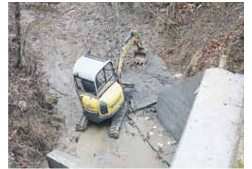
Most uległ poważnemu uszkodzeniu w wyniku powodzi, jaka miała miejsce 26 czerwca 2020 roku
