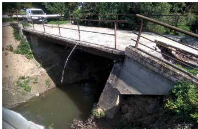
Zniszczony most na potoku Chmielnik w Kielnarowej
