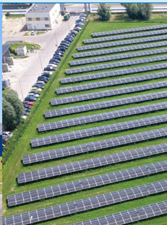
Instalacja fotowoltaiczna na Oczyszczalni Ścieków
