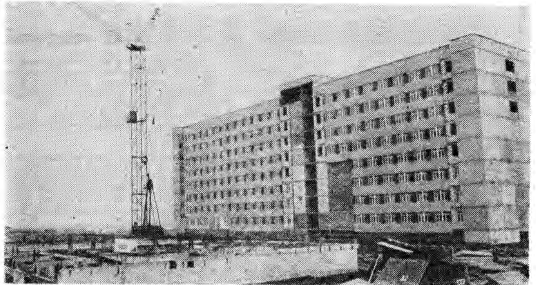
W bloku „łóżkowym” trwają już prace wykończeniowe, a nad powierzchnię ziemi wyrasta blok operacyjny.
