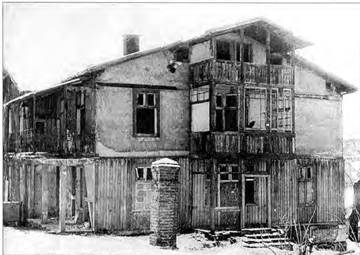
Przy ul. Parkowej 9 stoi częściowo zdewastowany dom.
