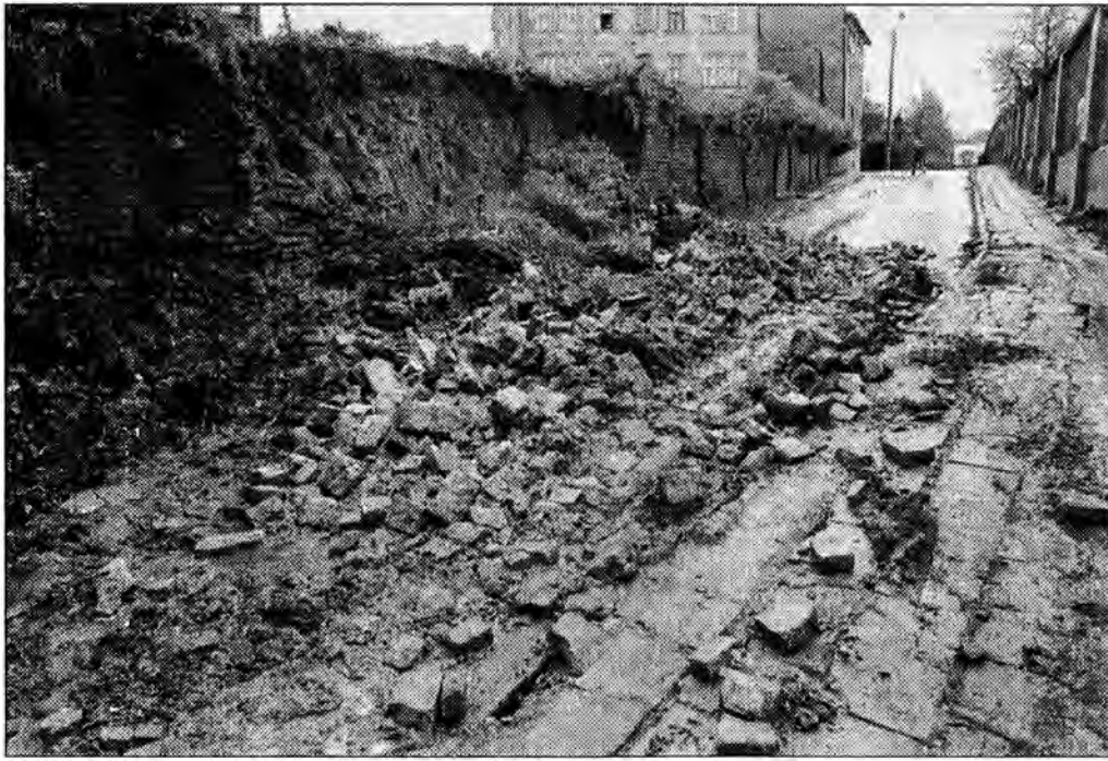
Na ulicy Rakocznego strumienie wody rozmyły mur oporowy.
