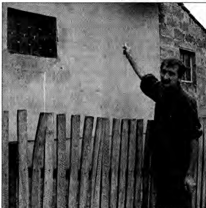
Henryk Kutyla: – Również na stajni pojawiły się pęknięcia.
