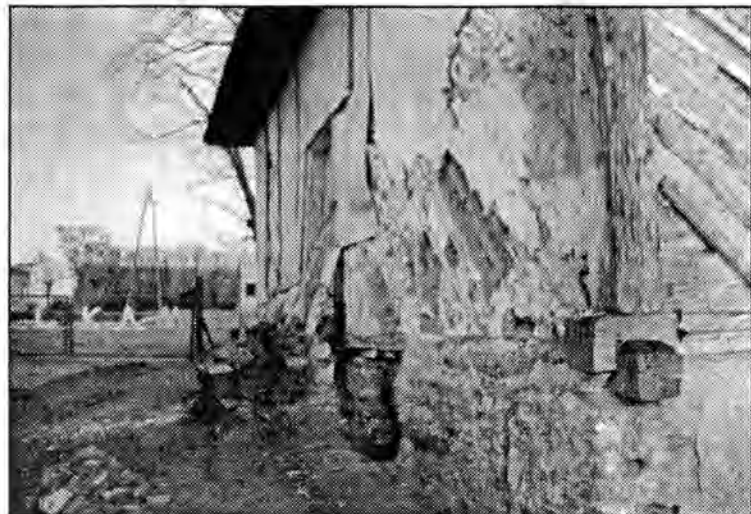
Dwór nie był remontowany od lat
