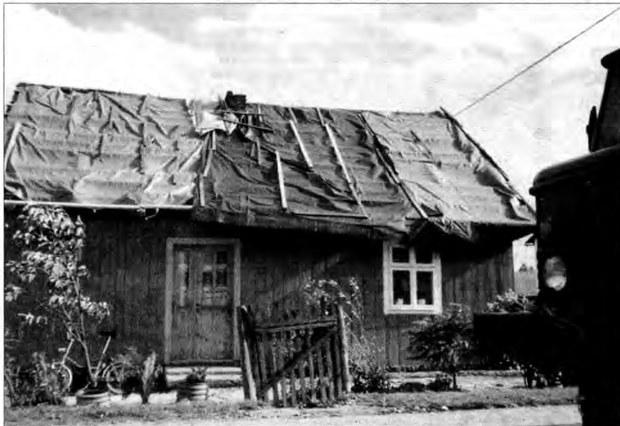
Tymczasowo za dachy służą plandeki.
