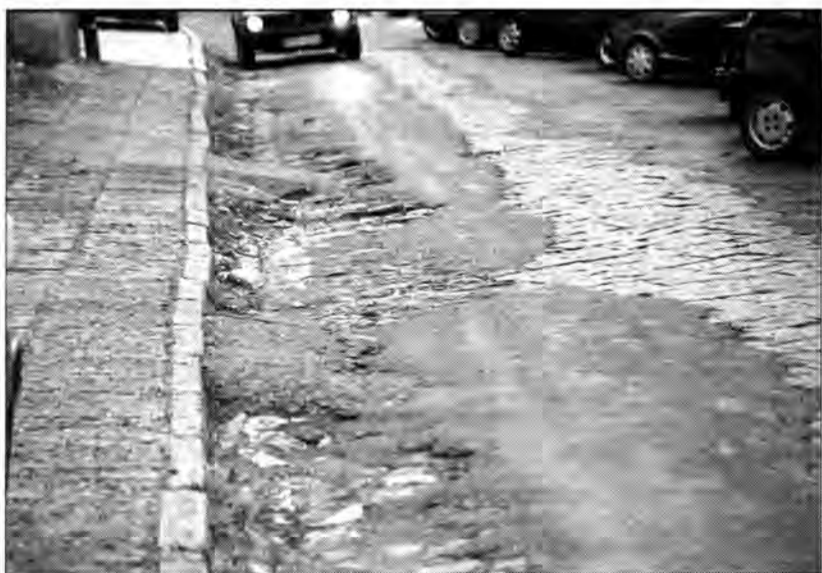
Ulicą Mniszą ciężko przejechać nie narażając się na uszkodzenie pojazdu.
