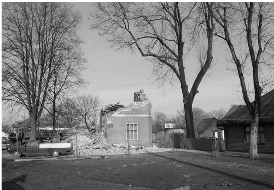
Rozbórka starej żydowskiej kamieniczki przy ul Nowy Rynek 5. Luty 2007 r., fot. W. Gąsiewski
