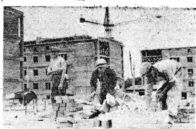
Szybko rosną mury nowego osiedla w Tarnobrzegu. Już w br. zostanie oddanych do użytku 150 mieszkań.
