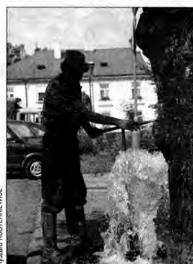
Przeplukiwanie sieci wodociągowej odbywa się przez system hydrantów przeciwpożarowych.
