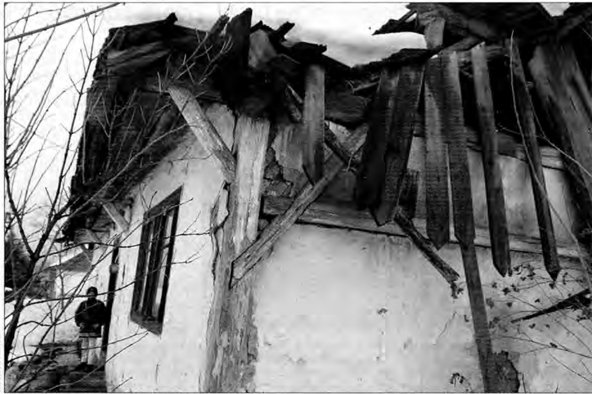
Pod ciężarem śniegu załamała się część dachu.
