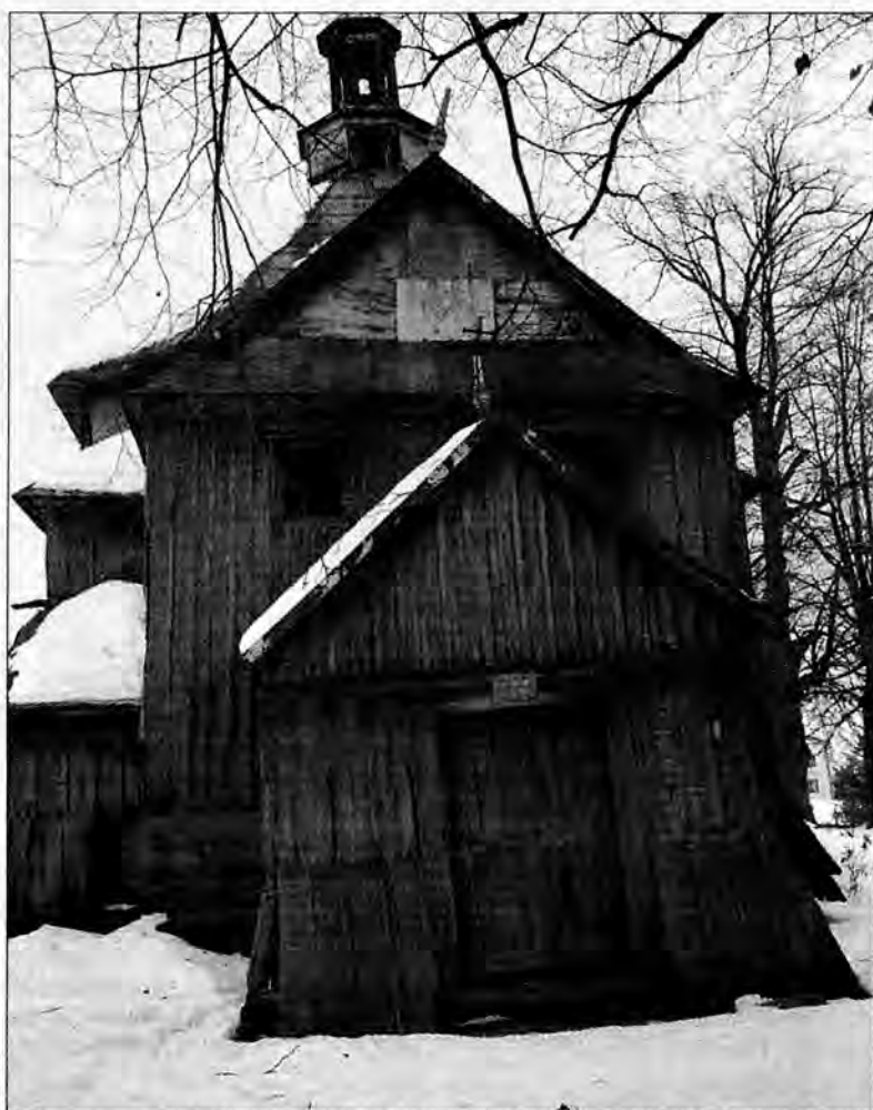
Zabytkowa cerkiew w Laszkach wymaga natychmiastowego remontu.
