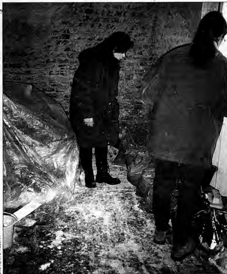
Miesiąc po pożarze. Teraz w pokoju córek nie ma sufitu ani okna.
