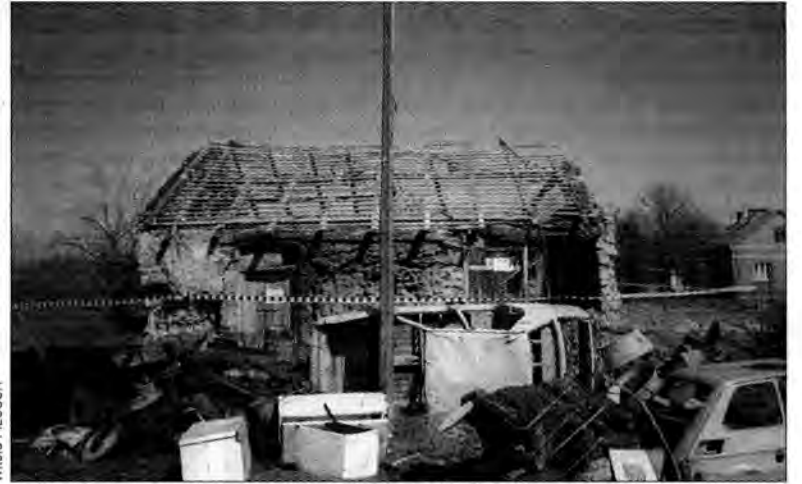
Resztki magazynu z chemikaliami są tylko tymczasowo zabezpieczone.
