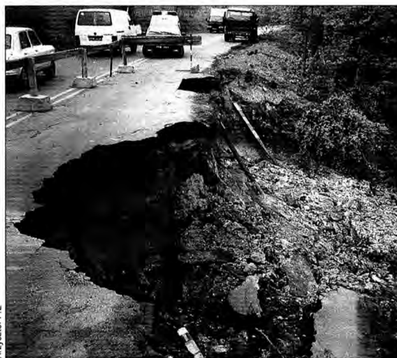
Nowe osuwisko na drodze między Dybawką a Krasiczynem.
