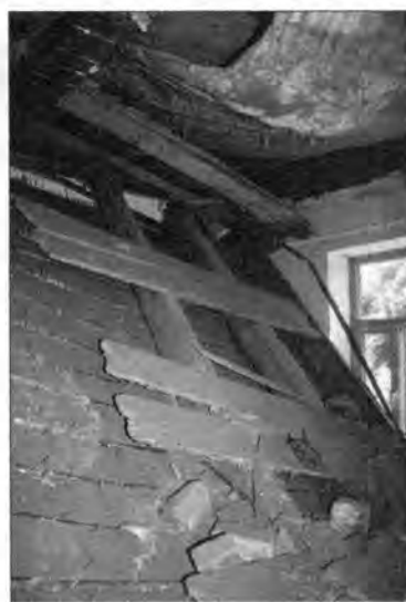
Zawalony strop w pokoju remontowanego mieszkania.
