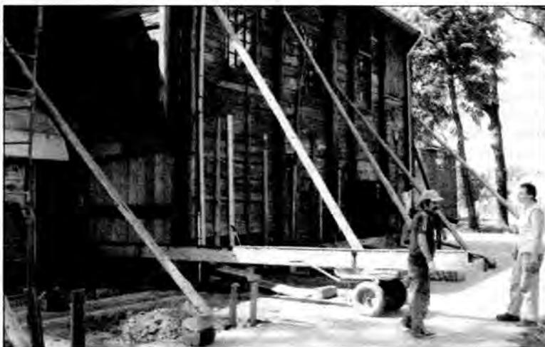
Konieczne było zamontowanie specjalnych podwalin pod kościół w Michałowie. W tym celu całą budowlę musiano podnieść do góry. By nie znacząca się chwila konieczne było domocowanie poprzecznych, bocznych pali.
