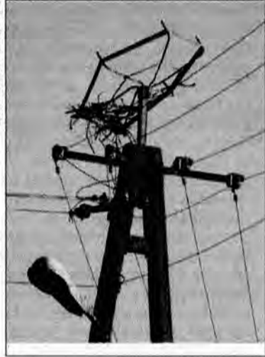
Pracownicy Posterunku Energetycznego w Lubaczowie po naszej interwencji zabrali gniazdo do naprawy.
