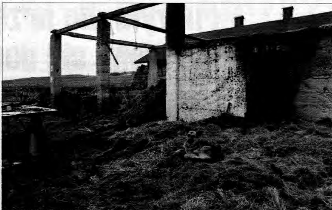
Łuczycy: Tutaj przyczyną pożaru było zwarcie instalacji elektrycznej.
