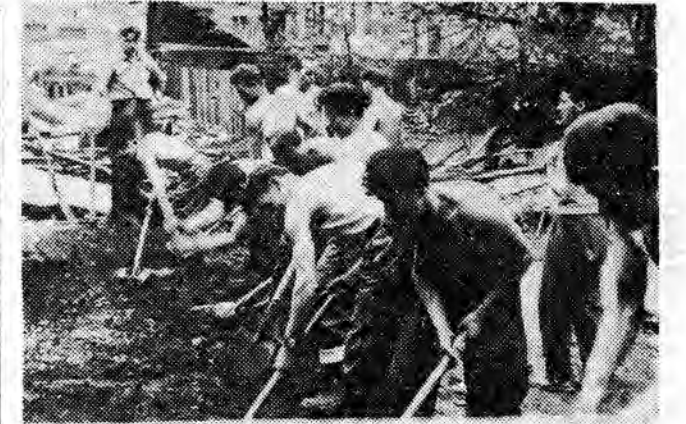
Uczestnicy kursów piekarskich organizowanych w ośrodku szkolenia „Społem” w Jarosławiu pomagali przy oczyszczaniu terenów budowy domu handlowego PSS. W ten sposób przyczynili się do przyspieszenia prac wykończeniowych. Na zdjęciu: Łopaty poszły ochoczo w ruch. Pracując uczestnicy kursu, nie szczerząc wolnego czasu po zajęciach szkoleniowych.
