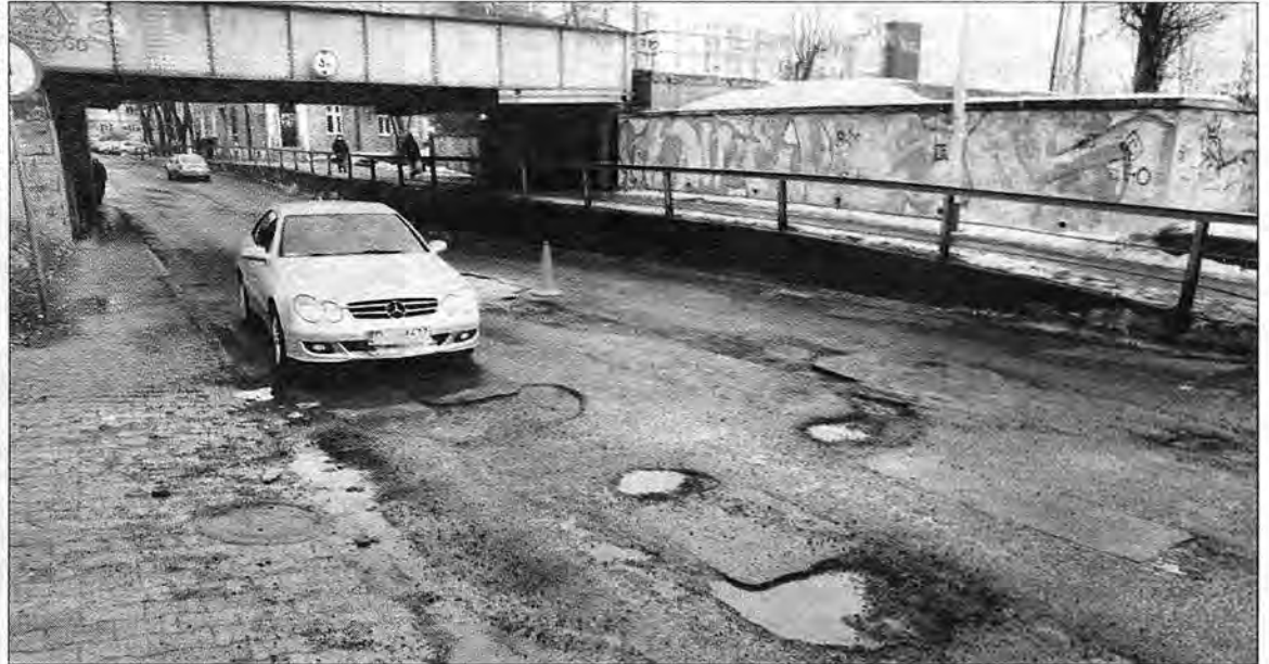
Słalom pomiędzy dziurami – taką dyscyplinę można było uprawiać przed kilkoma dniami, jadąc ulicą Krajską w Przemyslu. Drogowcy zdążyli już na szczęście załatać co większe ubytki.
